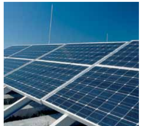
Solar cell array
